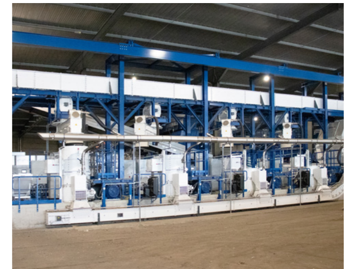
↑ Planta de reciclaje con una capacidad de 85.000 t/a
