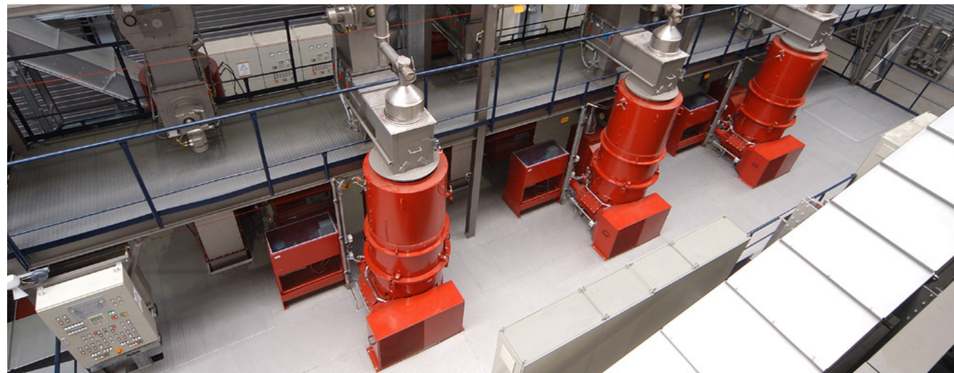
↑ Planta de reciclaje con una capacidad de 100.000 t/a
