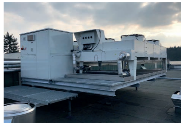
Installations de refroidissement
